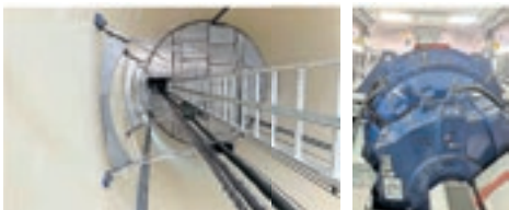
Eine Leiter führt im Windrad rund 160 Meter senkrecht die Wand hinauf. Das rechte Bild zeigt das imposante Getriebe der Anlage.
